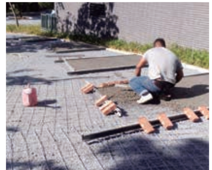
3) 鍍鋅點焊鋼絲網放置，伸縮縫按規畫施作，並以間隔分開的方式施作。
