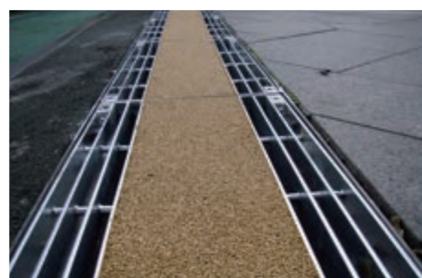
台北101機車道截水溝
