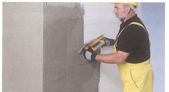
2 使用伊通專用批土材進行第一道批土作業，厚度 1-2 毫米。一天后再進行第二道批土作業，厚度 1-2 毫米
