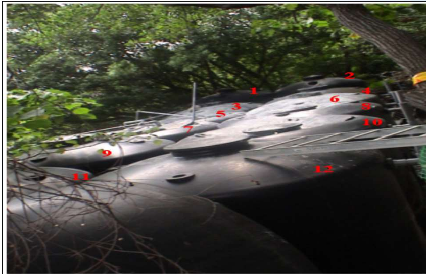
照片說明：災害發生之溫泉蓄水槽排列情形。
