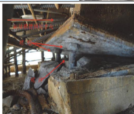
鋼柱接合處螺栓遭受破壞。
