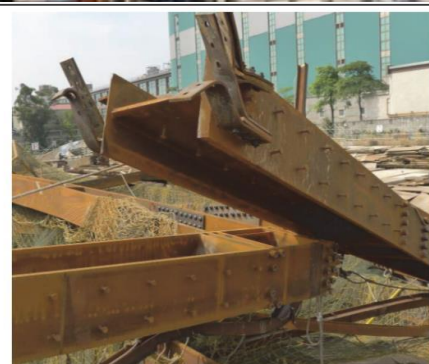
鋼骨鋼筋混凝土構造施工兩節柱間現場破壞。
