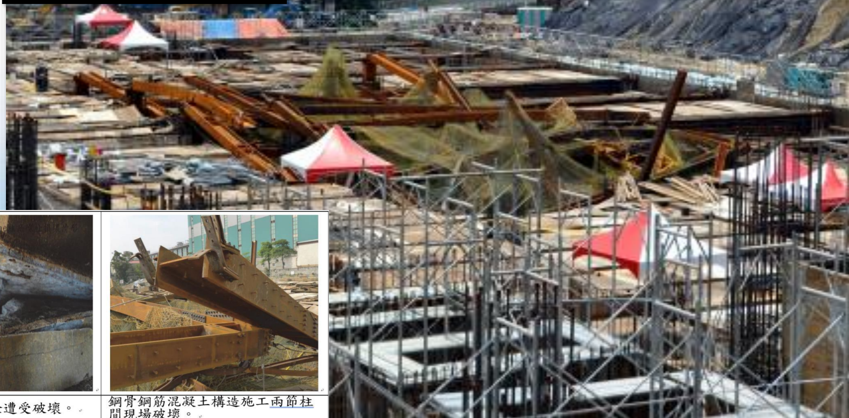
SRC 鋼構部分倒塌前
