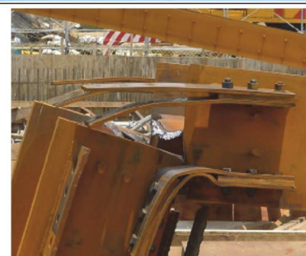
SRC 結構與鋼柱連結之螺栓已拔出。
