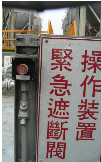
緊急遮斷裝置
