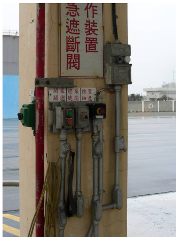
緊急遮斷裝置
