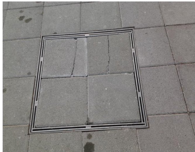
台北市 化妝蓋板 損壞情況
